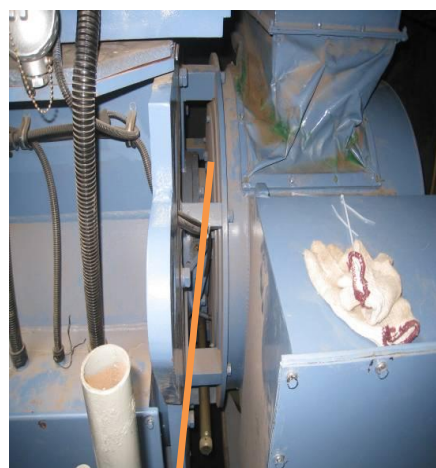
集电环罩端盖刷架安装孔
